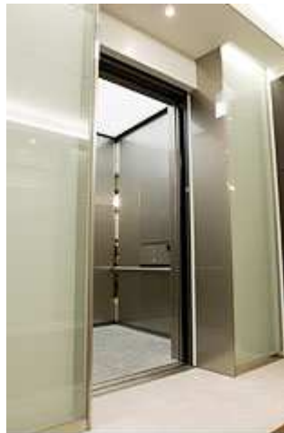
バリアフリーに対応したエレベーター (本社東京ビル)
