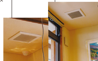
1台は更新、もう1台は増設。いずれもDCタイプ
